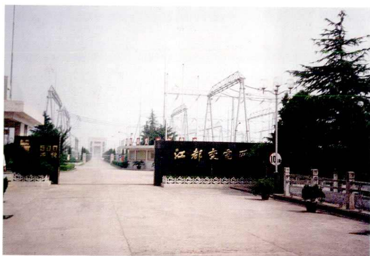
座落在吕庄村境内的 江都 500 千伏变电所
