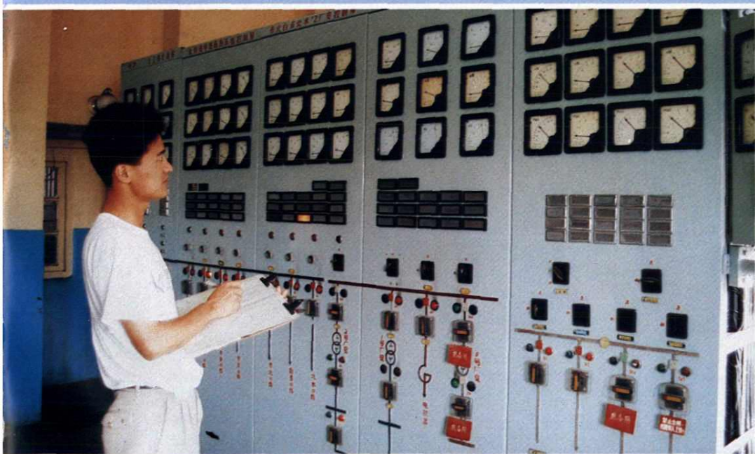
值班工正在抄录运行数据
