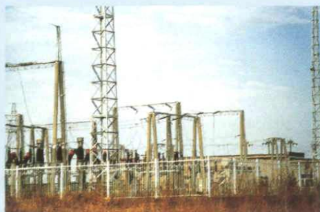
△ 库沙河变电站
