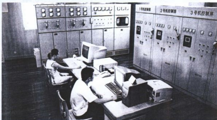
艇湖水电站中央控制室
