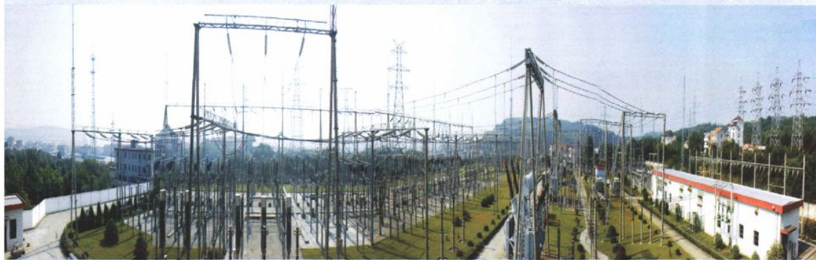
220 千伏雅致变电所
