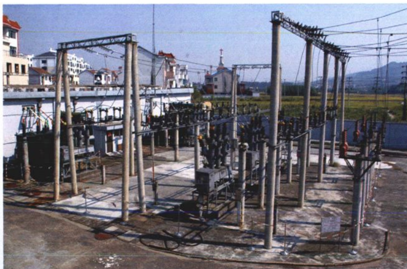
35 千伏长乐变电所
