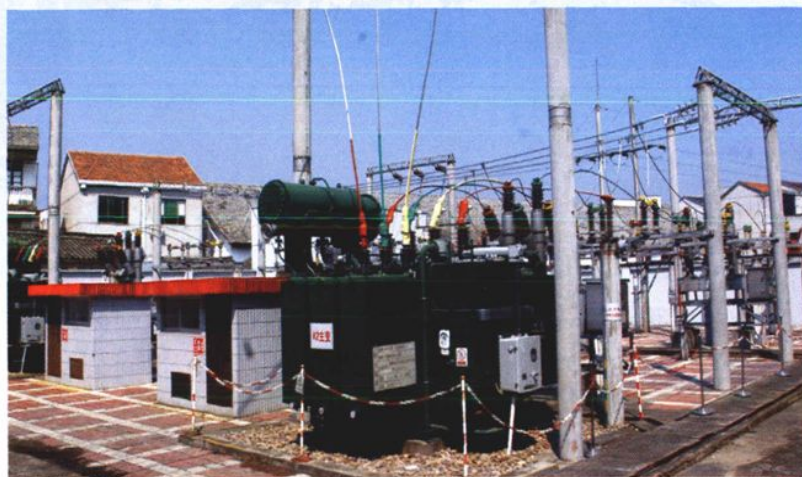
35 千伏崇仁变电所
