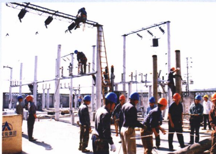
35 千伏黄泽变电所自动化改造
