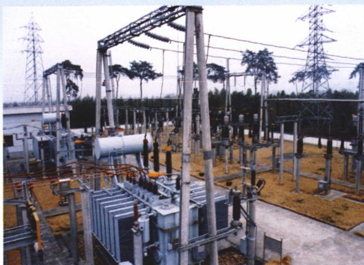
110 千伏嵊县变电所
