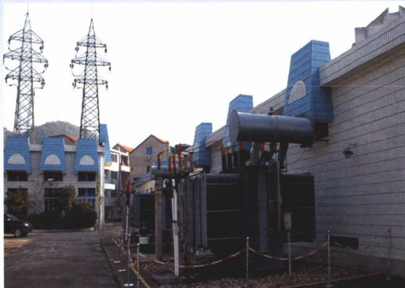
35千伏城关变电所
