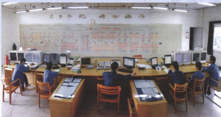
220 千伏雅致变电所中 央控制室
