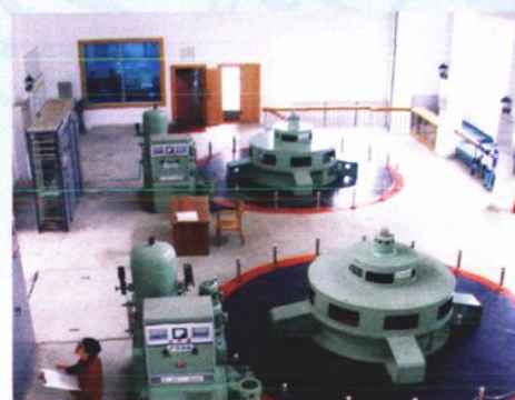
丰潭水电站发电机组
