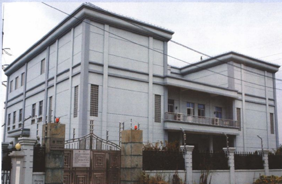
110 千伏新明变电所
