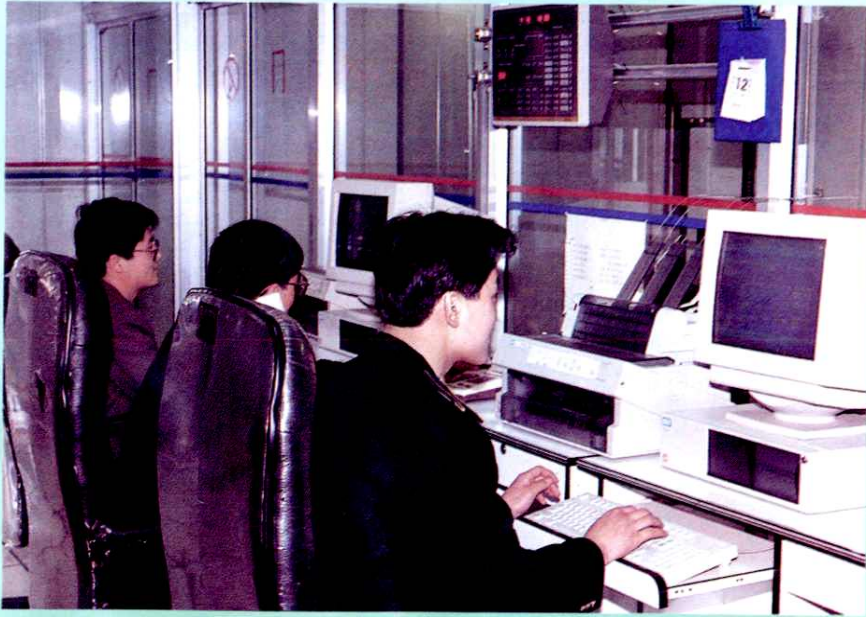
程控电话机房
