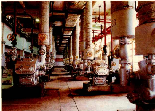
先进的制冷设备及生产线
