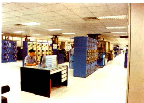
奥星公司光纤二次被覆车间
