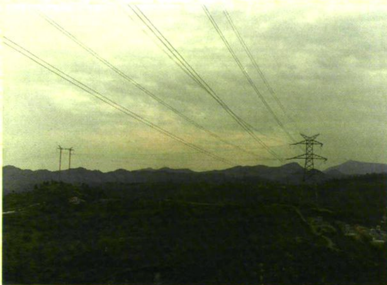
万安—赣州200千伏送电线路
