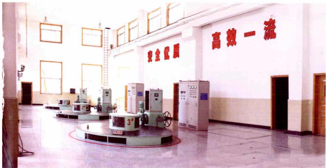
赋石水库电站厂房内景（机组）
