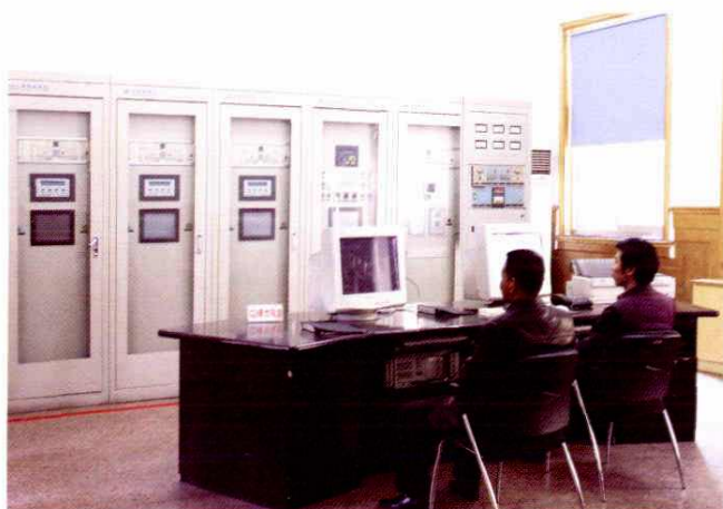
赋石电站自动化监控室
