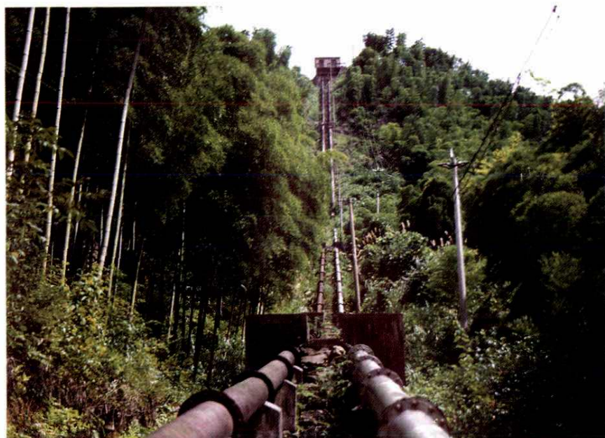
章村马 峰庵电站压 力管道
