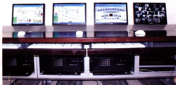
庆阳市档案 馆安防监控设施 主控室
