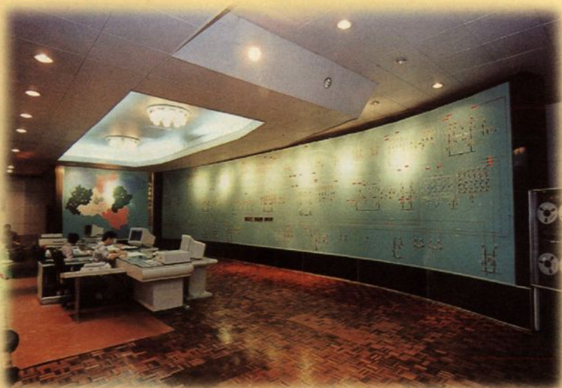
韶关电力工业局调度室
