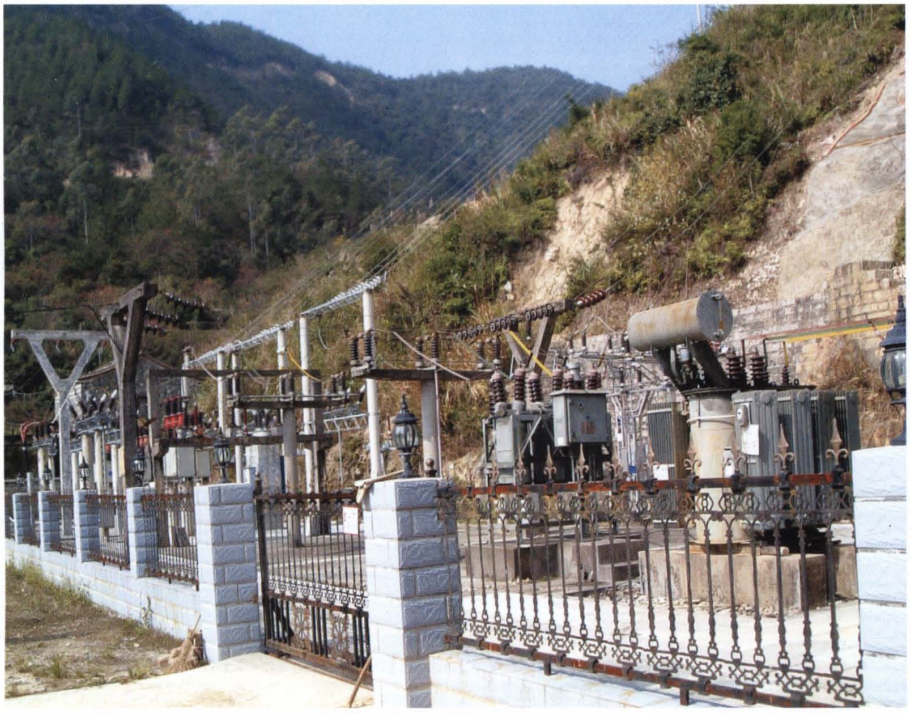
▼ 小平三级水电站变电站
