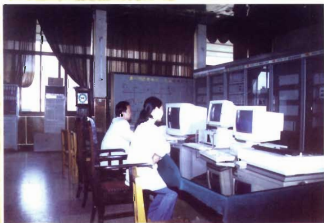
邓州变电站自动化控制系统
