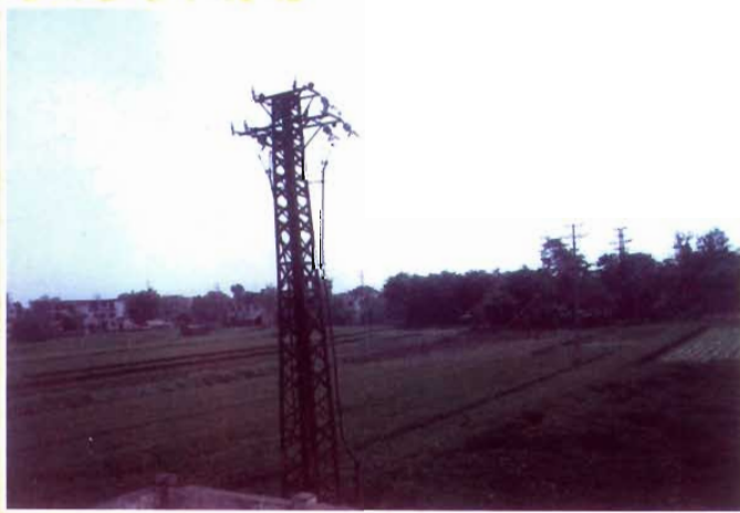
湍洲变电站35千伏出线
