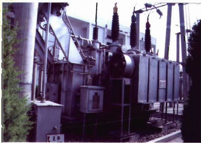
湍洲变电站主变
