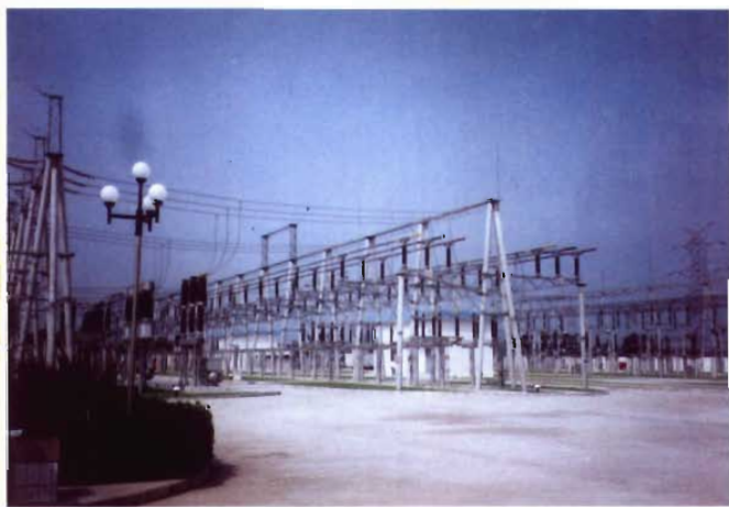
邓州220千伏变电站室外设施
