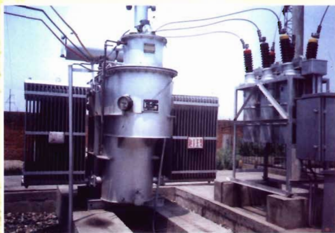
赵集变电站3150千伏安主变
