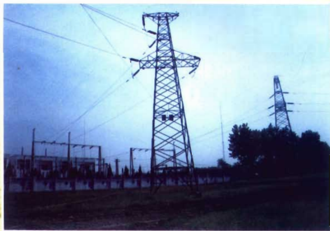
湍洲变电站110千伏进线
