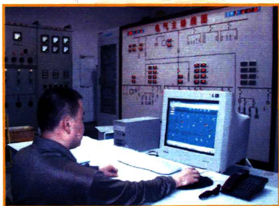
图为公司主控室数字化调度控制系统装置。
