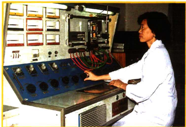
圖為公司標準計量室電度表檢測裝置。
