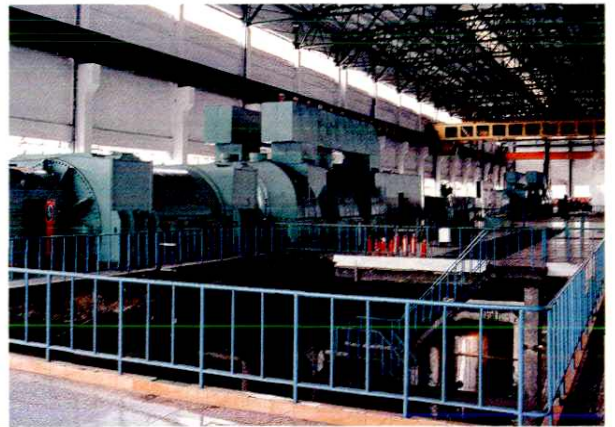
36 清镇发电厂20万千瓦机组
