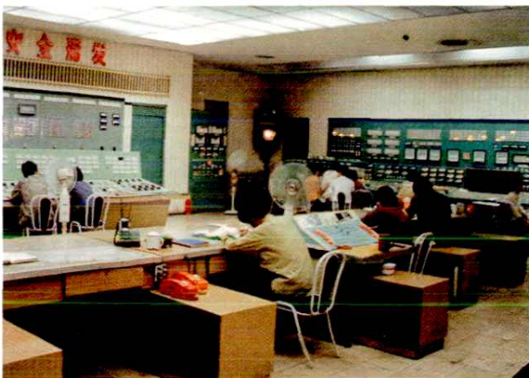
37 清镇发电厂的集控室
