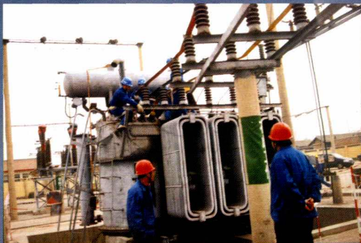
主变压器设备安全大检查
