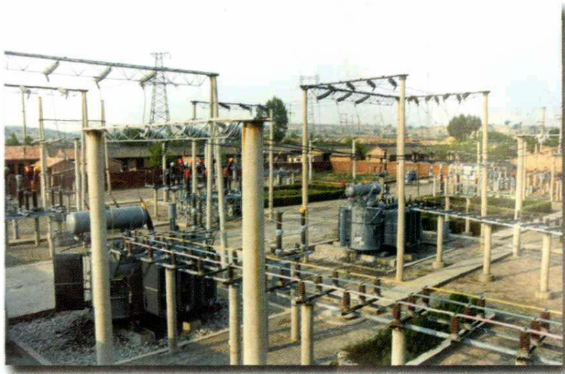
榆社110千伏变电站
