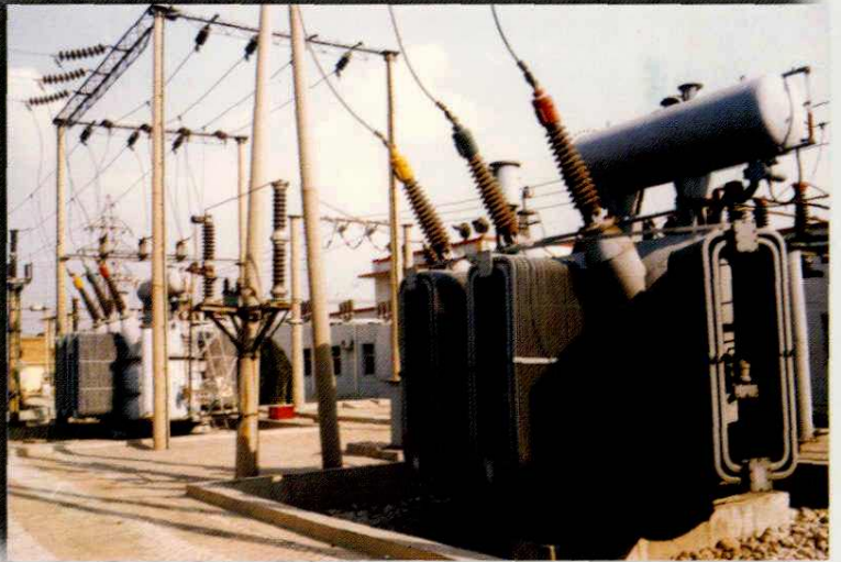
榆社二〇千伏变电站主变压器
