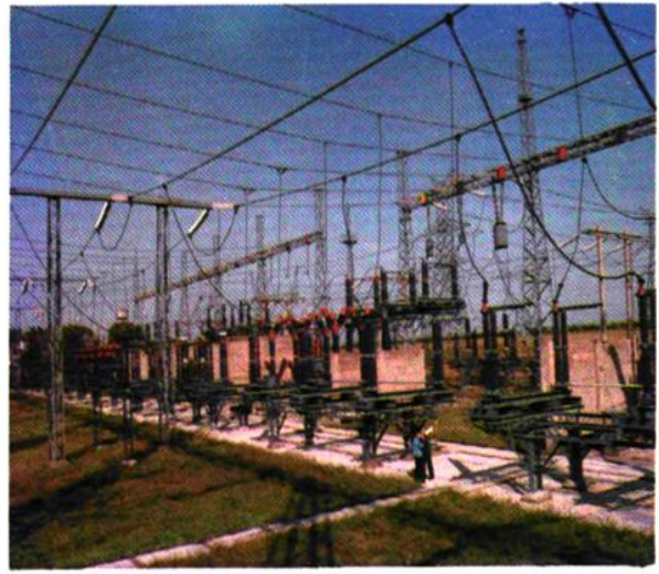
虎石台一次变 220 千伏设备
