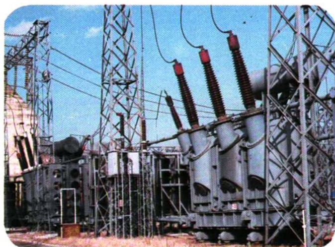
浑河一次变主变压器
