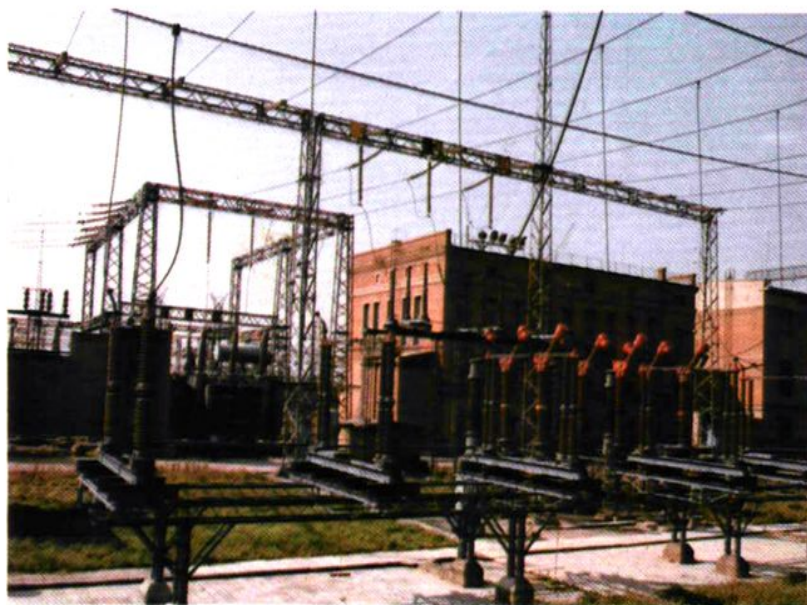
虎石台一次变主变压器及控制楼
