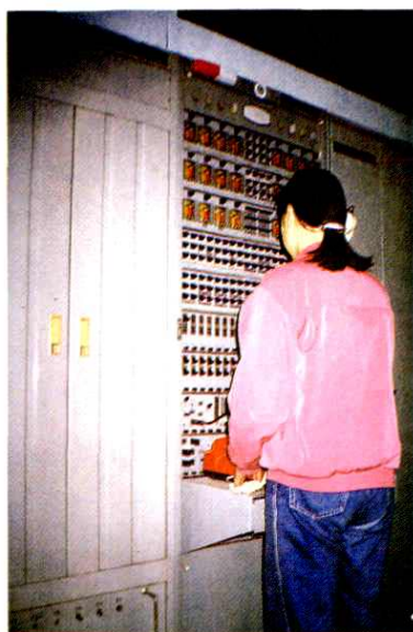
技术人员在调试光缆传输设备
