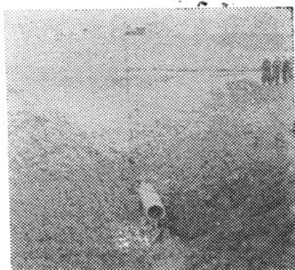
输水洞出坝后渗水排水管
