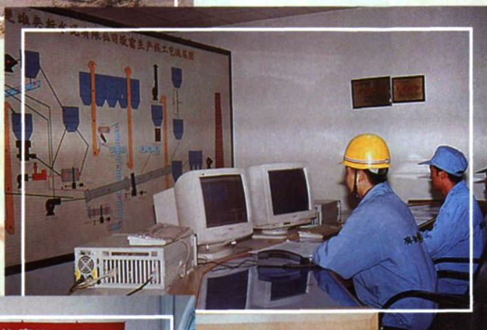
DCS 计算机中央控制室
