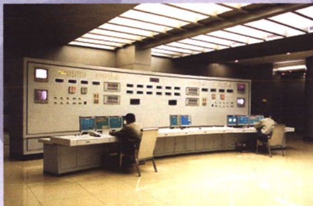
集中控制室（摄于2004年10月20日）
