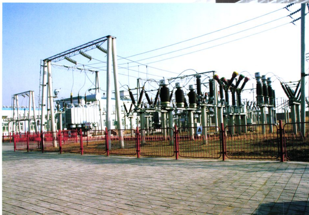
西城110千伏变电站
