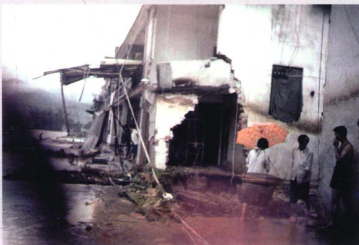
1994年6月，洪水冲毁寨岗镇新桥2层水泥民房
