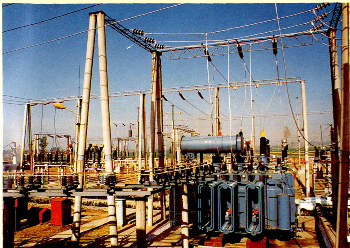
襄垣11万伏变电站
