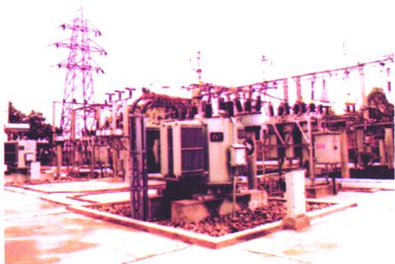
金龙山变电站
