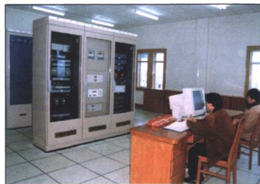
电 力 控 制 中 心
