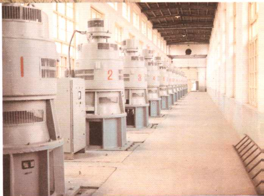
▶ 高坑扬水站泵室
