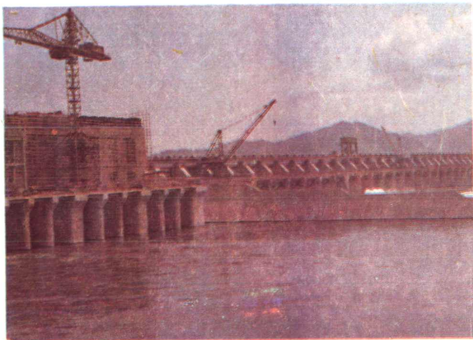
抚顺水泥厂生产的大坝水泥修筑的太平湾电站
