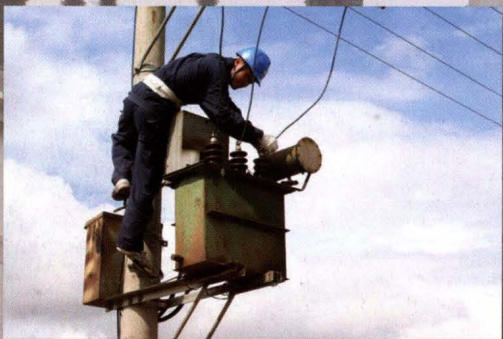
古恰供电所专职电工在变压器台前维修服务
