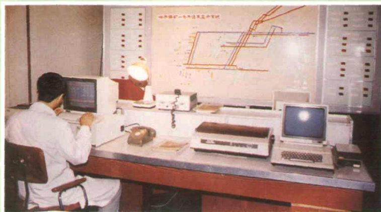
岭子煤矿瓦斯遥测报警系统
