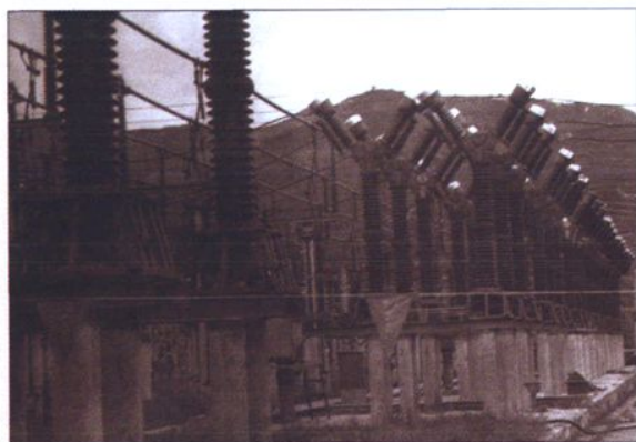
卧龙一次变电所 220 千伏开关场
