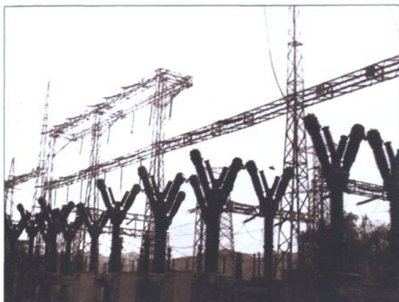
东风一次变电所 220 千伏开关场
