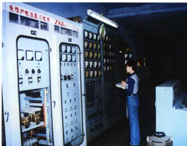
六陈电站控制室
