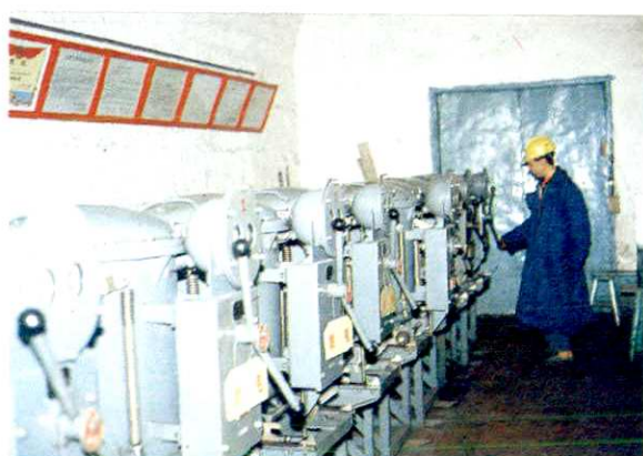
井下中央配电室
