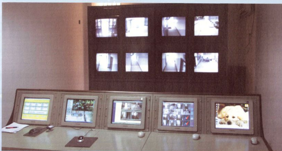
江宁区档案馆监控室
