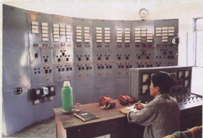
东方红电站控制室
