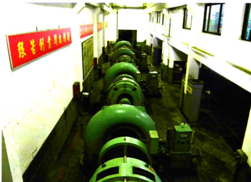
庆元马蹄岙水电站地下厂房
