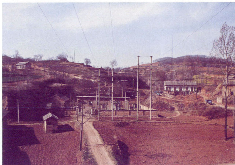
夏县泗交35千伏变电站
