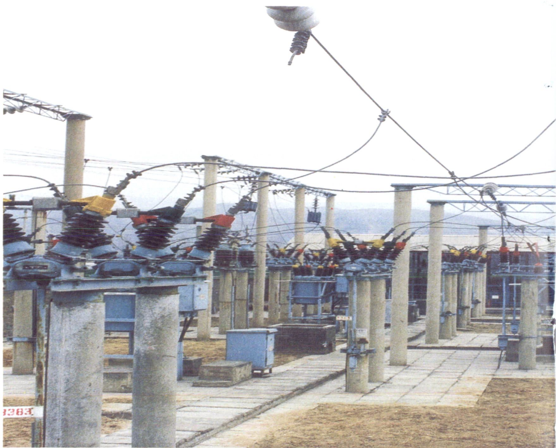
夏县苗村110千伏变电站
