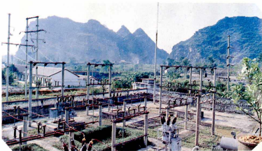
响水桥中心变电站
