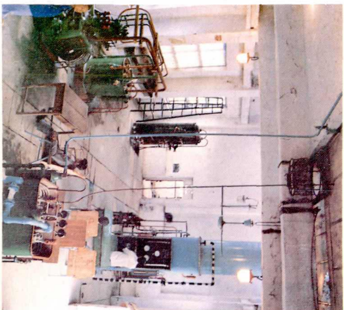
中军潭水电站制氧车间
