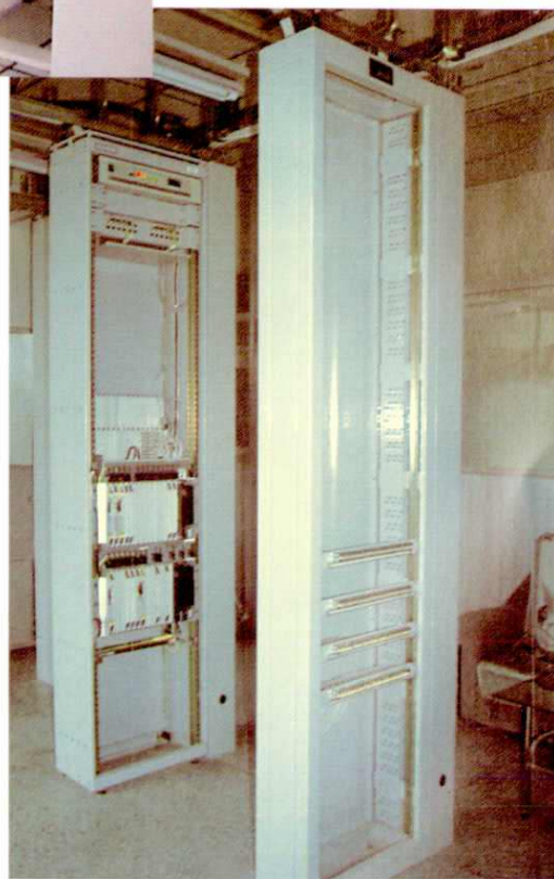
1996年巴楚局光缆开通,图为光缆机房。
