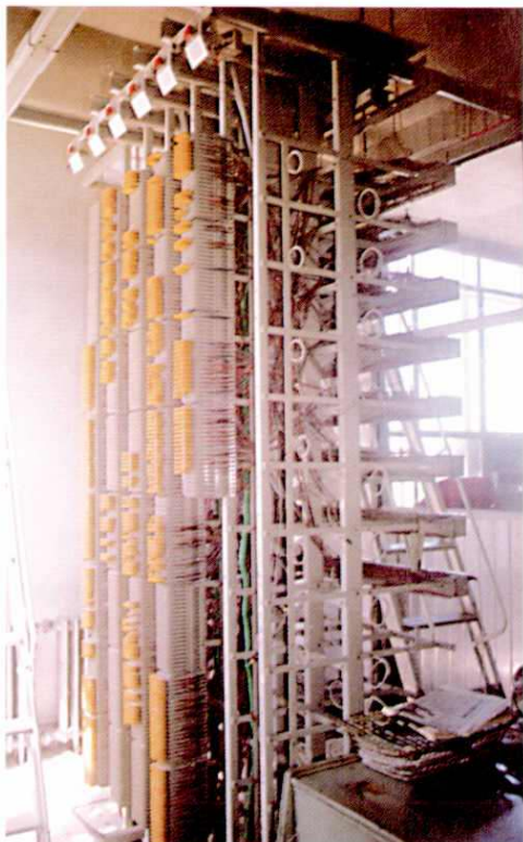
县局程控机房总配线架。
