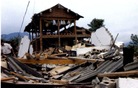
宁洱县新平村房屋倒塌严重
