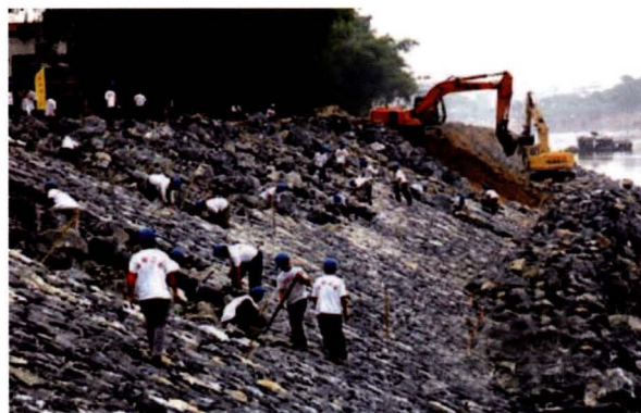
广东省台山市抓紧修复水毁工程
