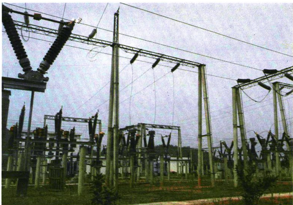
下源变电站外景
