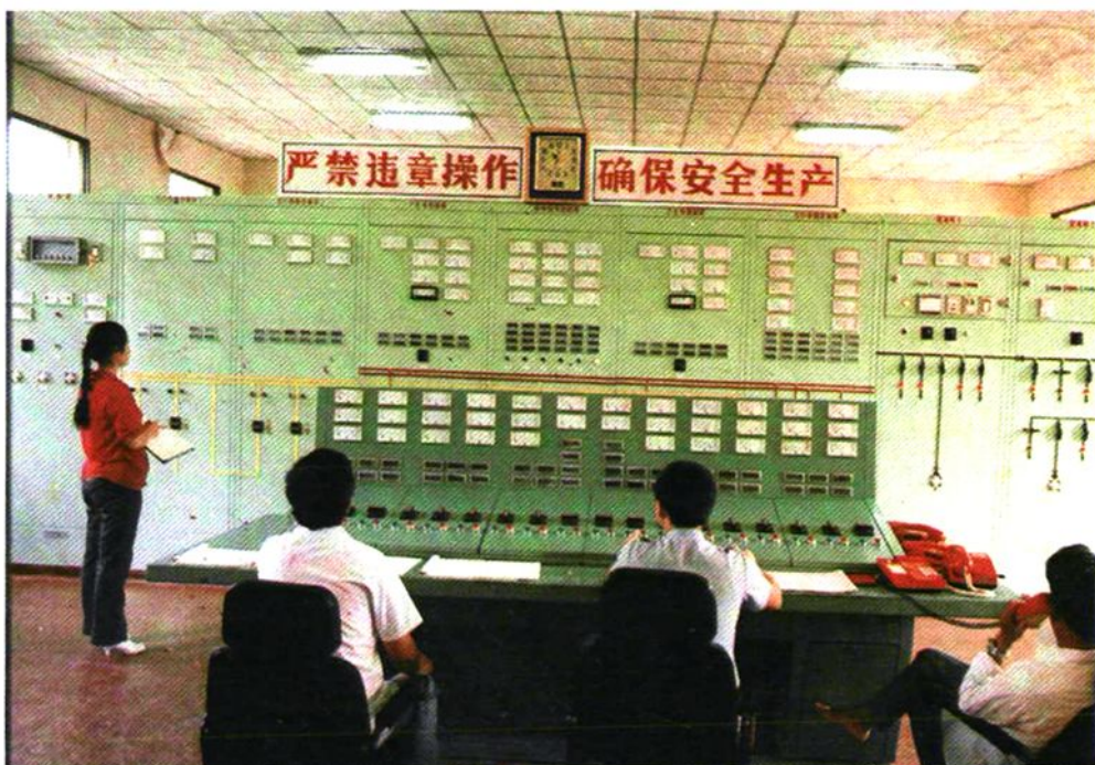
下源变电站调度室
