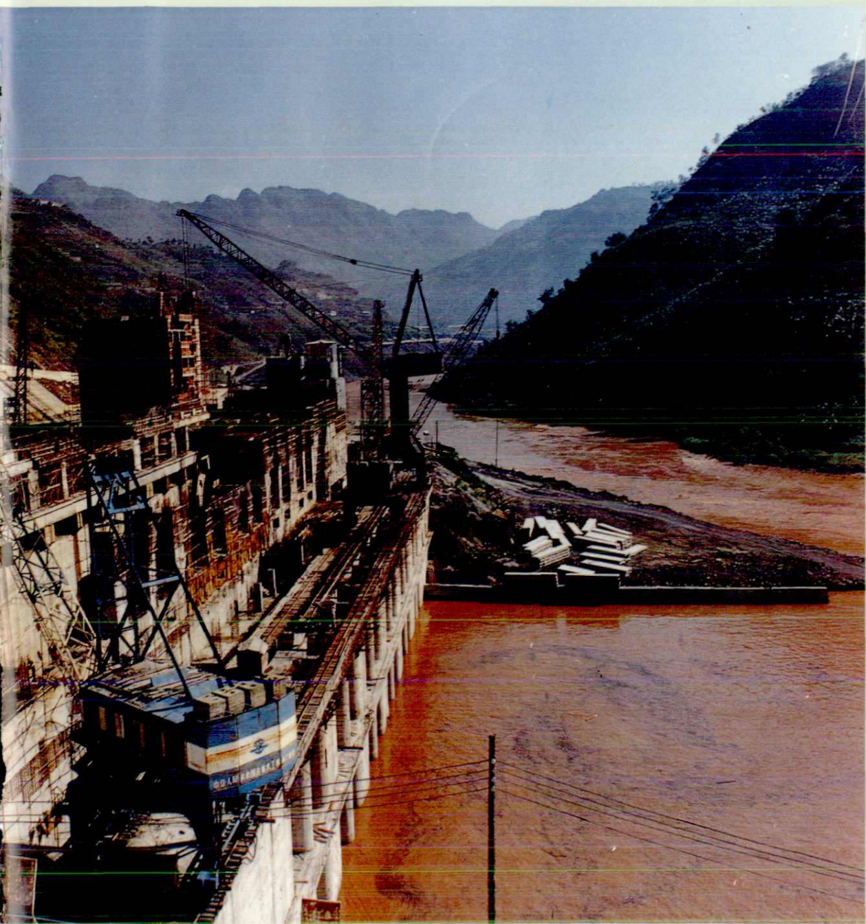
正在建设的天生桥水电站（二级），装机 4 \times 22 万千瓦，预计第一台机组于1992年建成发电
