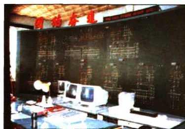
乌兰察布地区电力调度室
