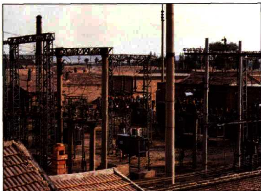
丰镇市 35 千伏城关变电站
