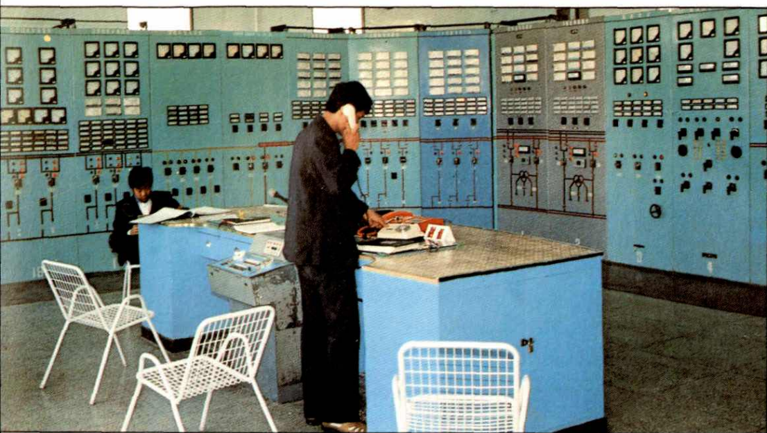
寿阳县白家庄变电站控制室
