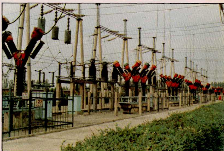
平遥 220 千伏变电站设备
