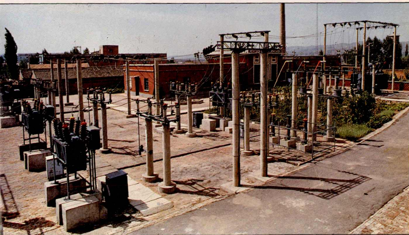
和顺县 35 千伏变电站设备
