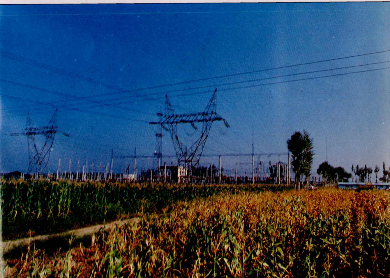
1973 年架设的 220 千伏娘子关至榆次线路
