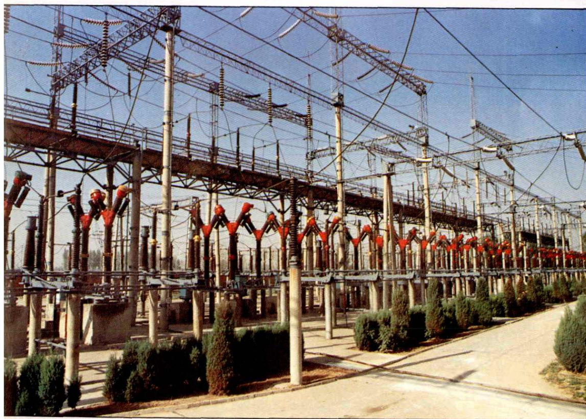
榆次使赵变电站 220 千伏双母线
