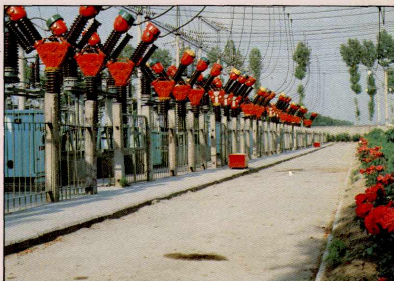
寿阳县白家庄变电站 220 千伏设备
