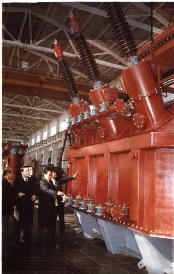
三门变压器厂试制的油浸式电力变压器
