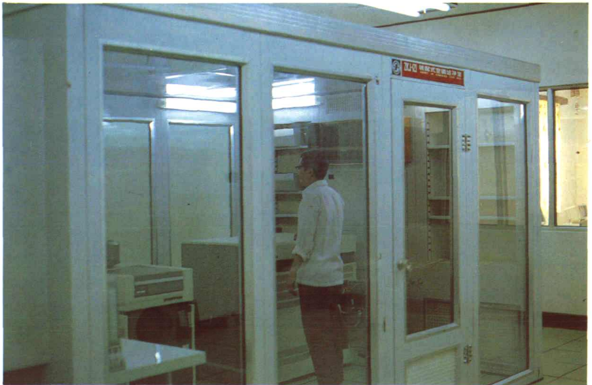
厂电子计算机中心总机室
