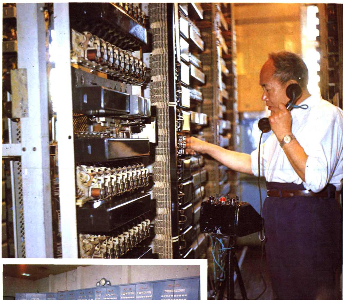
厂电话自动交换台
