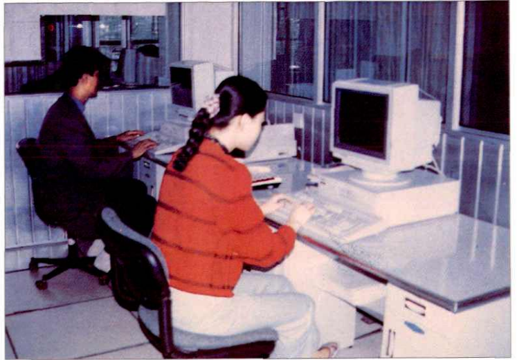
阿克苏地区局程控电话机房
