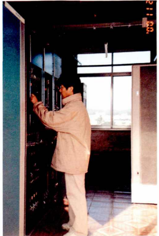
移动电话机房一角
