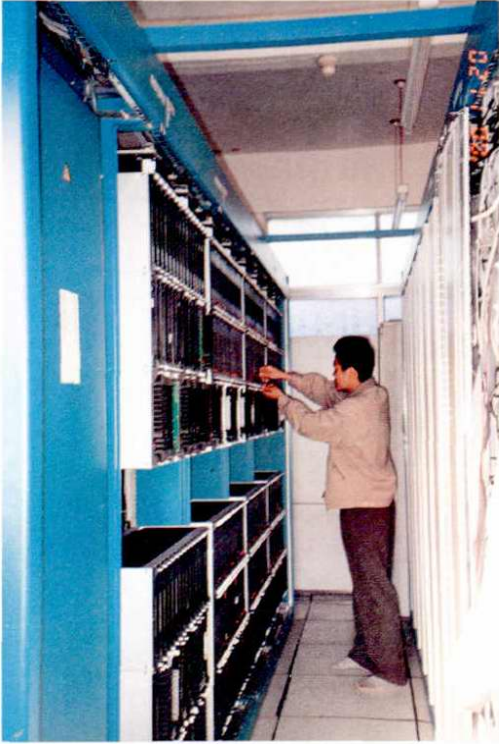
1995年建成的通信大楼程控机房一角
