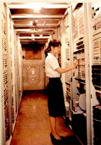
1992年开通的纵横制自动交换机机房
