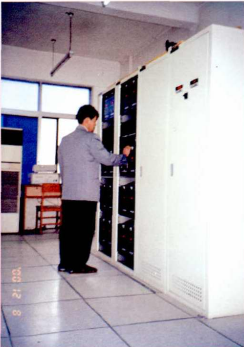
整流器机房一角
