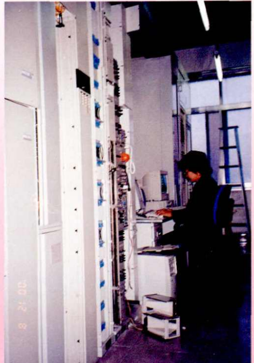
传输机房一角
