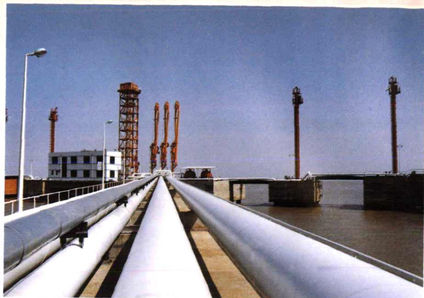
岙山石油转运储油管
