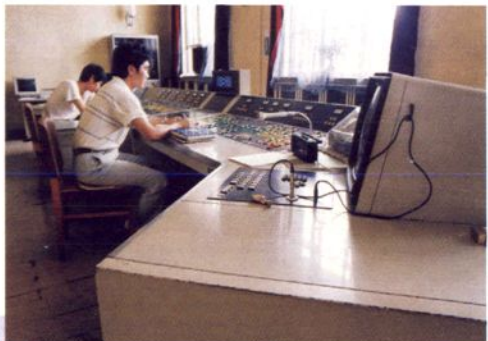
京秦线 AT 供电系统微机远动监控中心。京秦电气化铁路 1987 年获国家银质奖。
