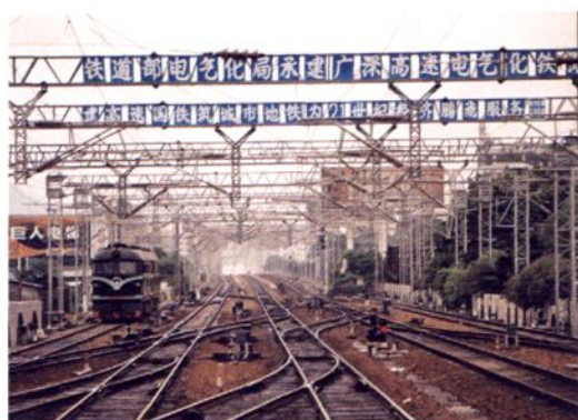
深圳站电气化铁路接触网
