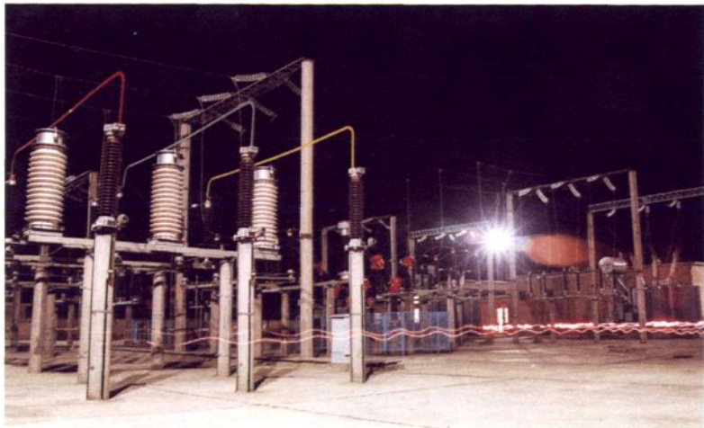
中国目前海拔最高的电气化牵引变电所——兰新线兰武段天祝变电所
