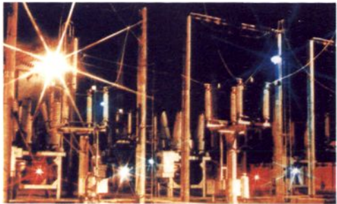
中国在京秦线首次采用 AT 供电方式的牵引变电所
