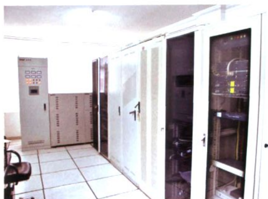
县供电公司调度机房 (胡 荣 摄)
